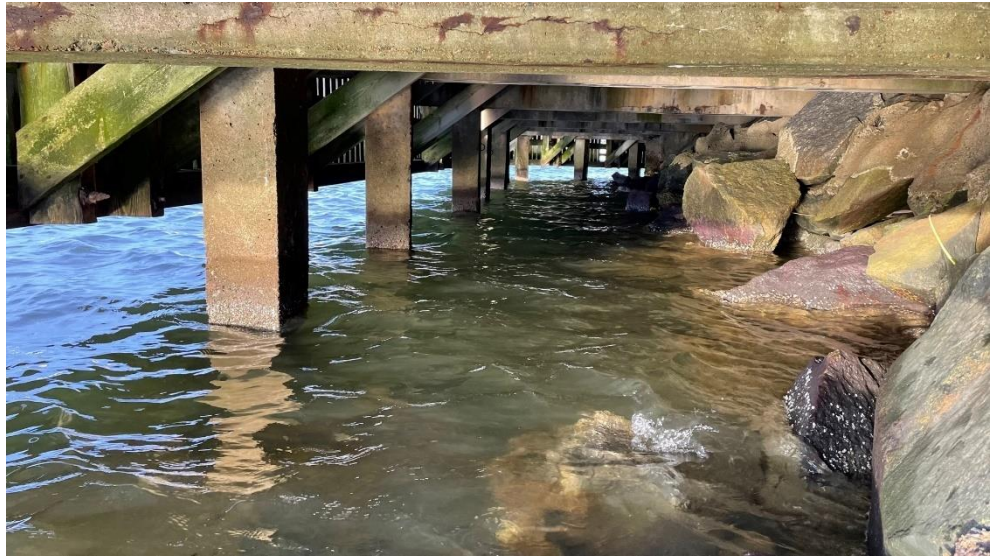
Figur 10 Foto under befintlig träbrygga med synlig slänt/erosionsskydd (COWI 2022-03-25)
